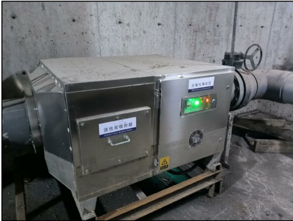
污水处理站废气治理设备（光催化净化+活性炭吸附）
