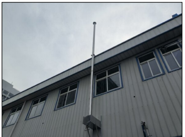
制剂室废气排气筒
