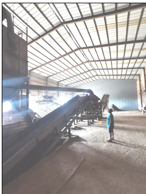
一条废钢破碎生产线
