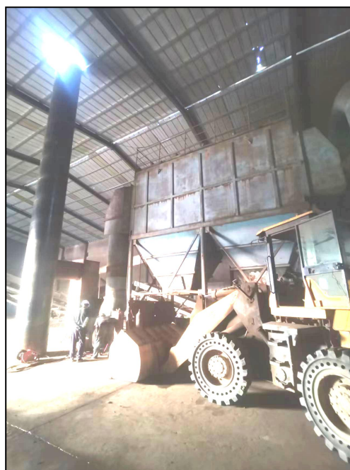
旋风除尘器+布袋除尘器+15m 排气筒
