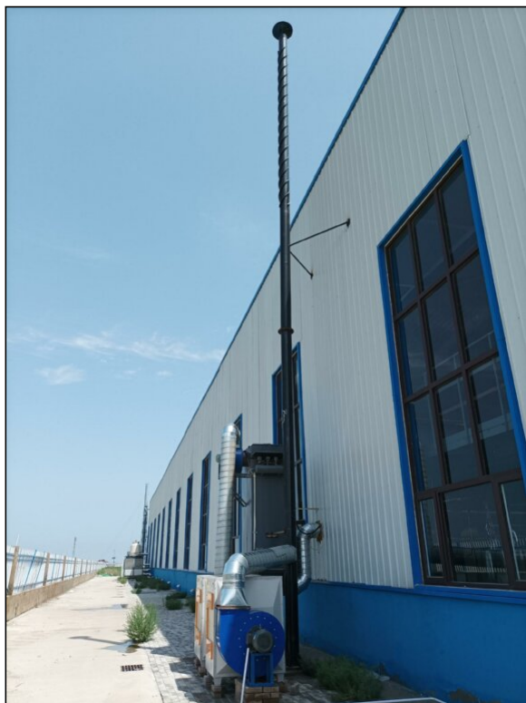
布袋除尘器+二级活性炭+排气筒
