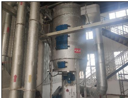
布袋除尘器+20m 高排气筒 (DA001)
