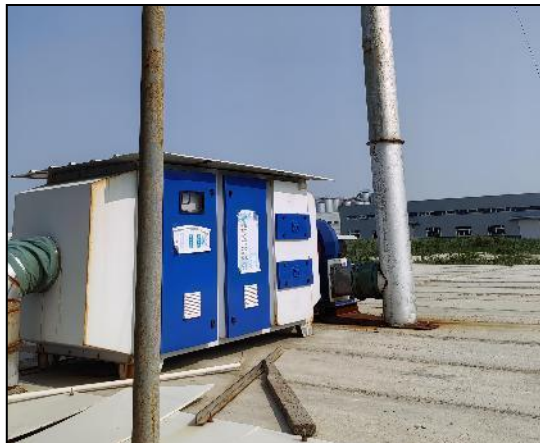
UV 光氧活性炭吸附一体机+15m 高排气筒 (DA002)
