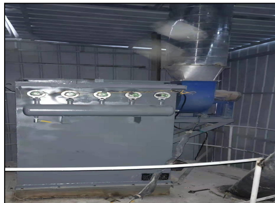
仓顶布袋除尘器
