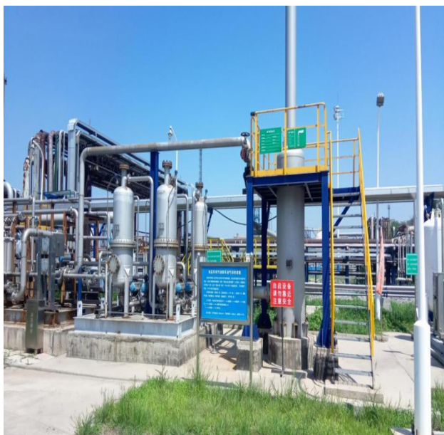
图 3-1-1 油气吸收+膜分离+吸附，处理装置
